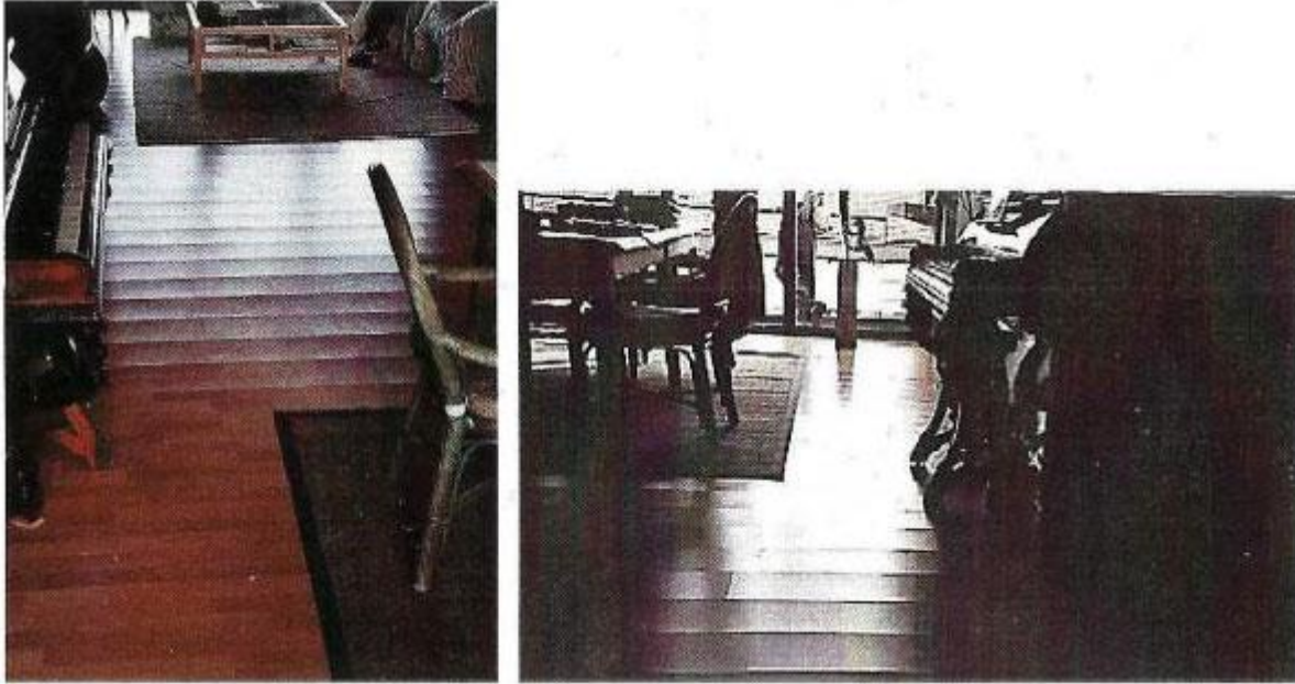
Figura 3: Levantamiento de juntas producido por humedad.
